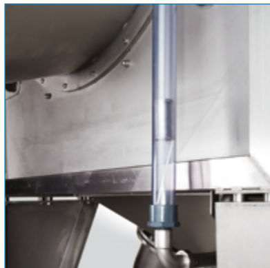
Water level control Füllstandskontrolle
